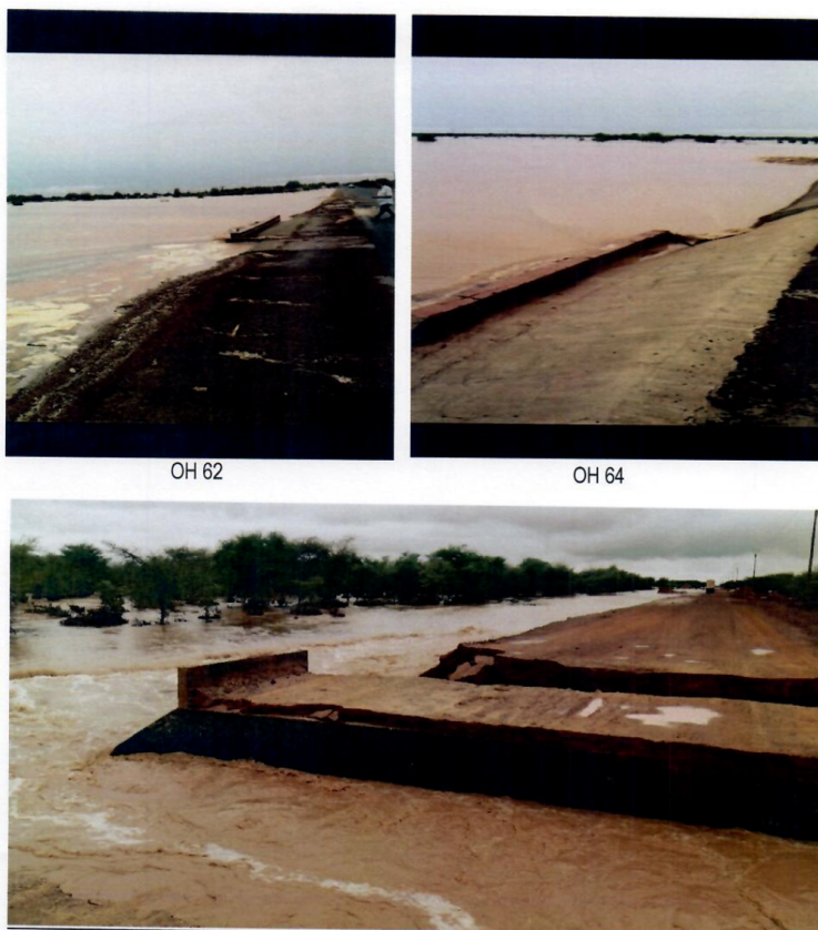
Photo 4 : Ruptures de routes
