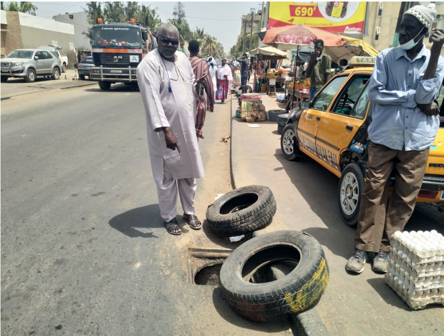
Photo 2 : Regards bouchés à Colobane avec des eaux usées, couvercle vandalisé et mise en place de pneus pour signaler sa présence
