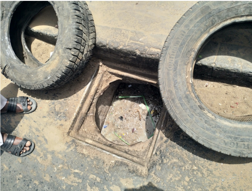
Photo 3 : Regards bouchés à Colobane avec des eaux usées, couvercle vandalisé et mise en place de pneus pour signaler sa présence
