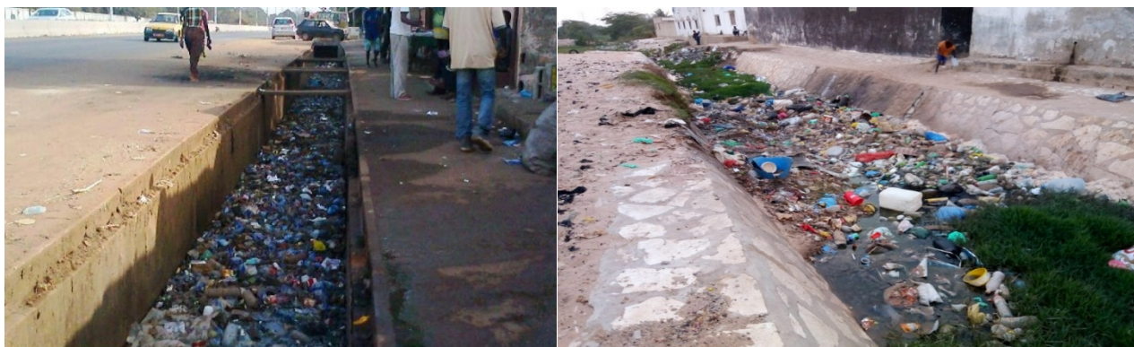
Photo 5 : Rejet de déchets solides dans un canal d'évacuation des eaux.
